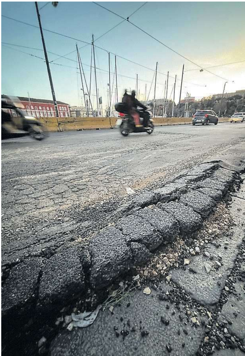
L'asfalto di via Acton sbriciolato dopo le ultime piogge NEAPHOTO A. GAROFALO
